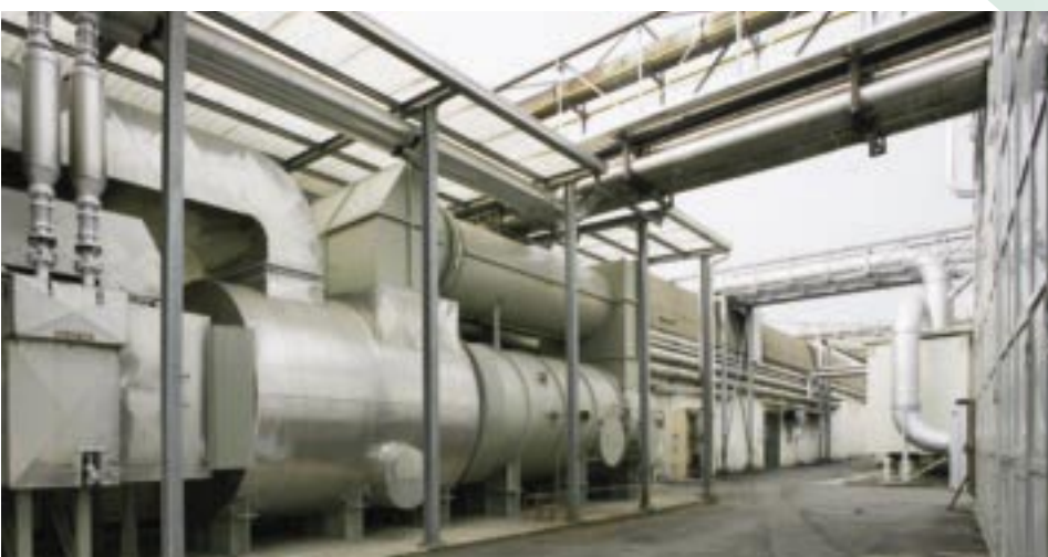
IMPIANTI ECOLOGICI DI COMBUSTIONE ECOLOGICAL COMBUSTION PLANT
